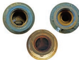
Entrada y salida de los reguladores de presión desgastados.
