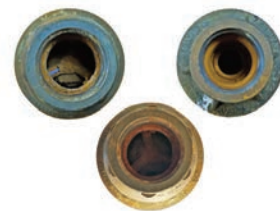
Entrada e saída de reguladores de pressão desgastados.
